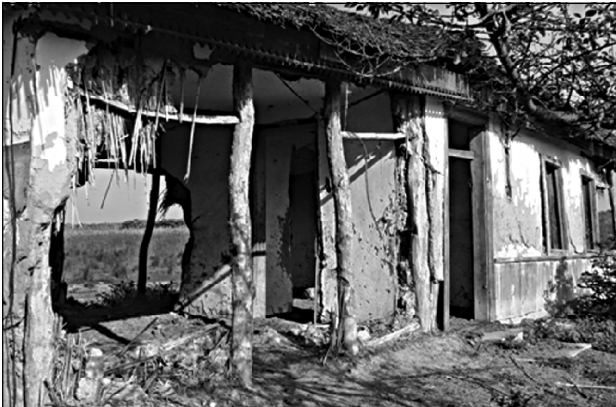
182. Фрагменти каркасу стін трьохкамерного житла. Село Сфинту Георге. Повіт Тульча. Фото автора.
